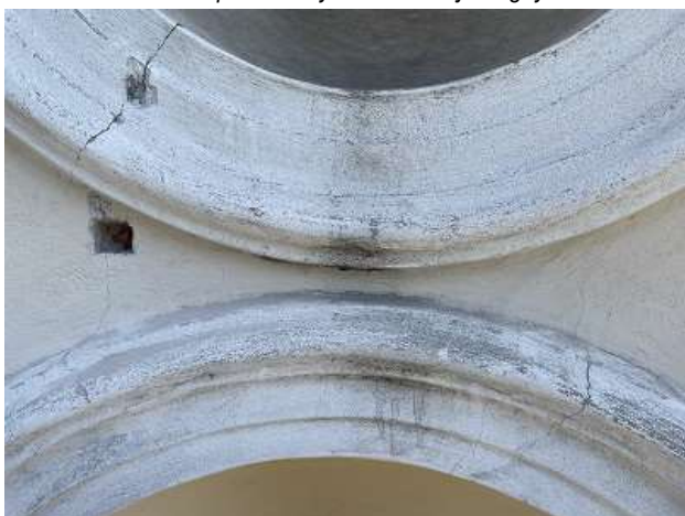
Fot. 39 Przykład uszkodzenia w nadprożu.
