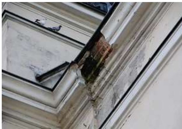
Fot. 31 Widok uszkodzeń gzymsu.
