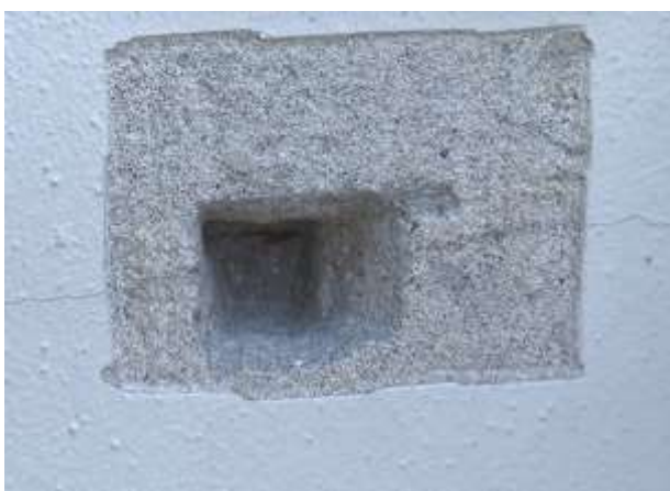
Fot. 41 Przykład uszkodzenia tynku, odkrywka nie wykazała zarysowania struktury muru..
