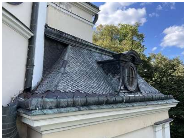
Fot.63 Widok dachu ze śladami zużycia pokrycia i obróbek.
