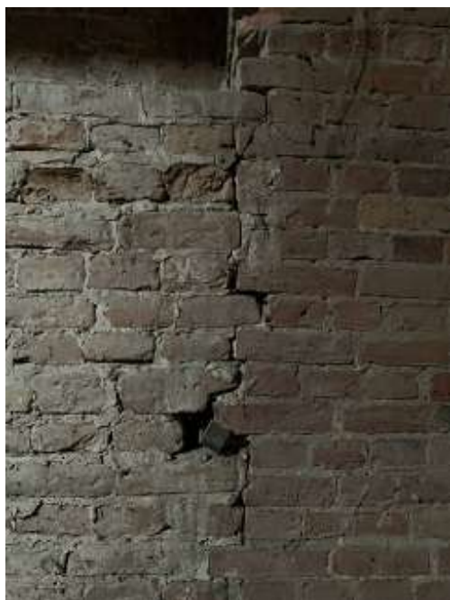
Fot. 29 Widok niezwiązanego muru w części dobudowy.
