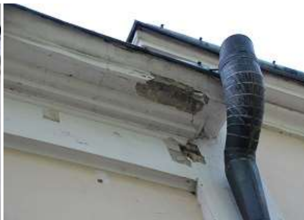
Fot. 32 Widok uszkodzeń gzymsu.
