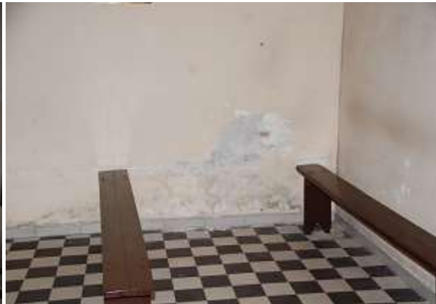
Fot. 28 Widok zawilgoceń ścian wewnątrz kościoła – nawa boczna.
