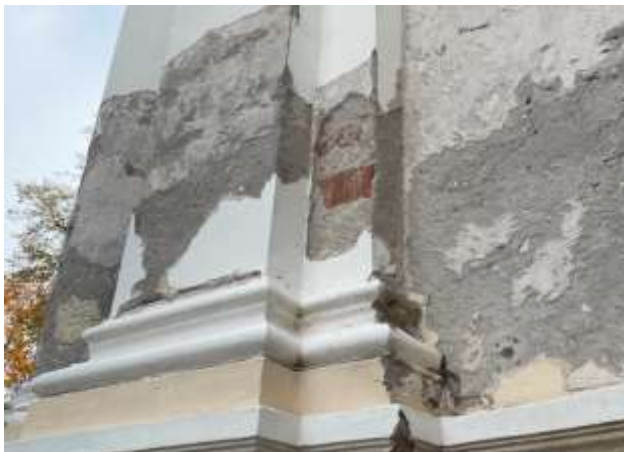
Fot. 43 Przykład uszkodzenia tynku, odkrywka cegieł w miejscu włoskowatych rys na tynkach
