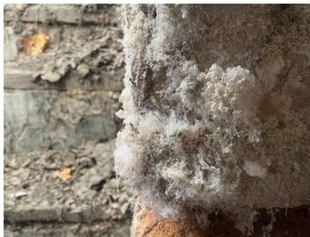
Fot. 19 Zdjęcie przedstawiająca wykwit zasolenia ścian.
