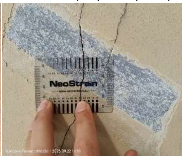
Fot. 26 Pomiar rozwartości rysy na ścianie bocznej – 0,9mm.
