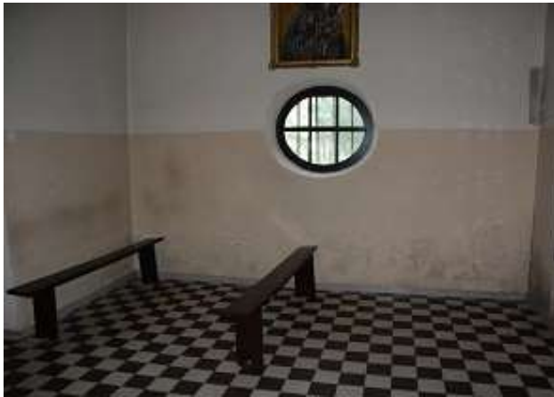
Fot. 27 Widok zawilgoceń ścian wewnątrz kościoła – nawa boczna.
