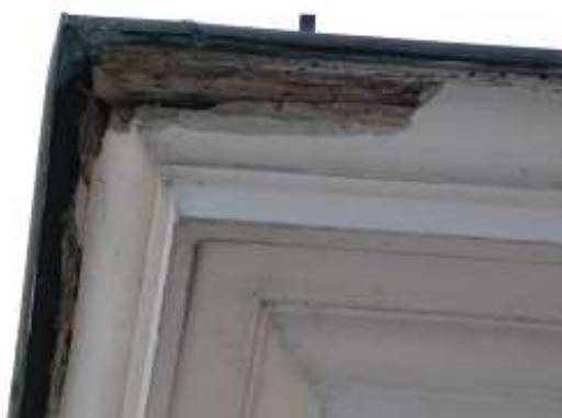
Fot. 33 Przykład uszkodzenia gzymsu.
