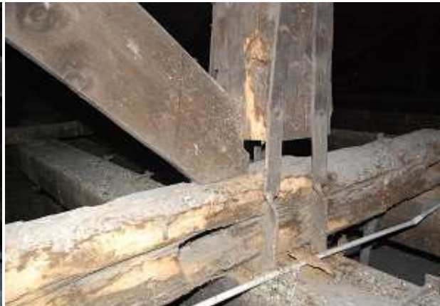
Fot. 58 Przykład korozji drewna.
