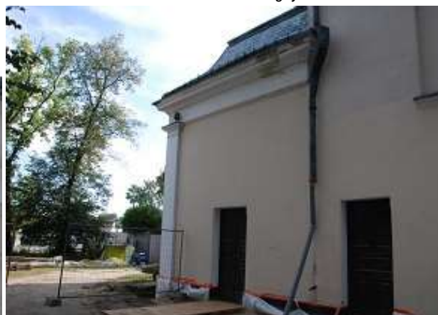
Fot. 34 Przykład uszkodzenia gzymsu przy rurze spustowej.
