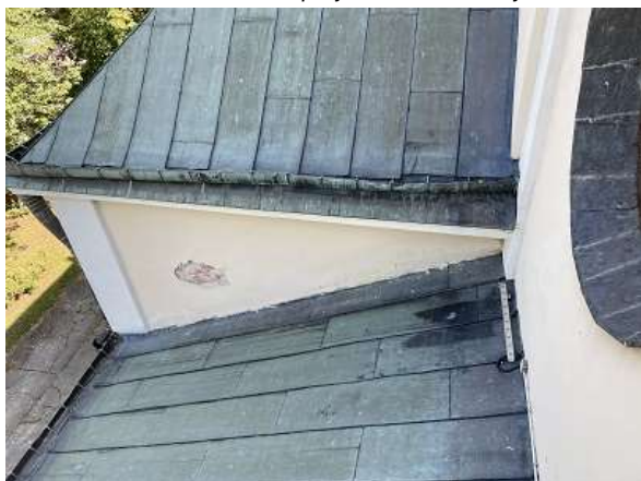
Fot. 61 Przykład uszkodzenia rynny ze złym spadkowaniem.
