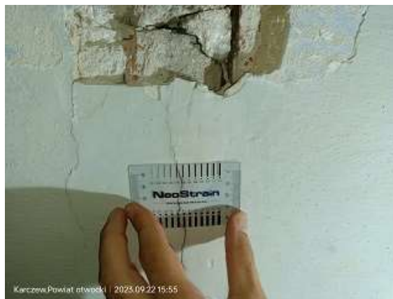
Fot. 54 Widok pomiaru rozwartości rys w odkrywce - 0,5mm.
