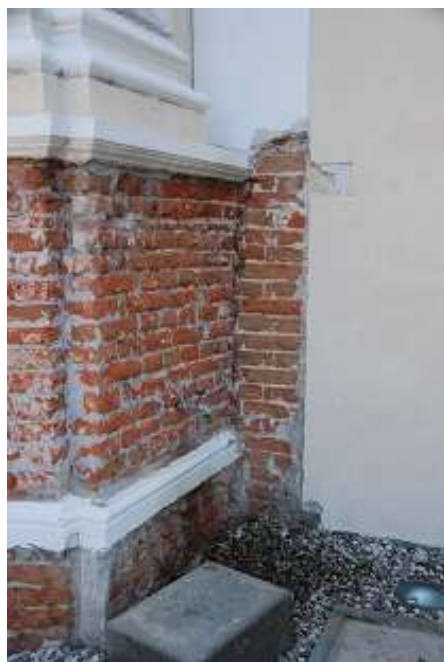
Fot. 30 Widok niezwiązanego muru na dobudówkach zewnętrznych na froncie.
