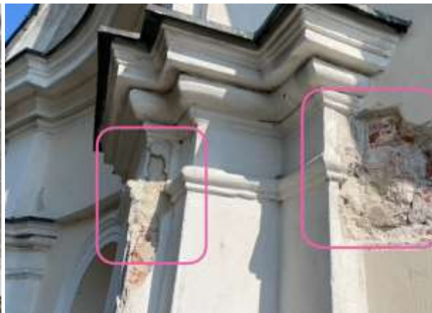
Fot. 44 Przykład odspojień tynków na gzymsach.
