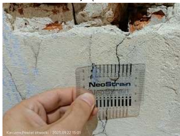
Fot. 52 Widok pomiaru rozwartości rys w odkrywce - 0,8mm.
