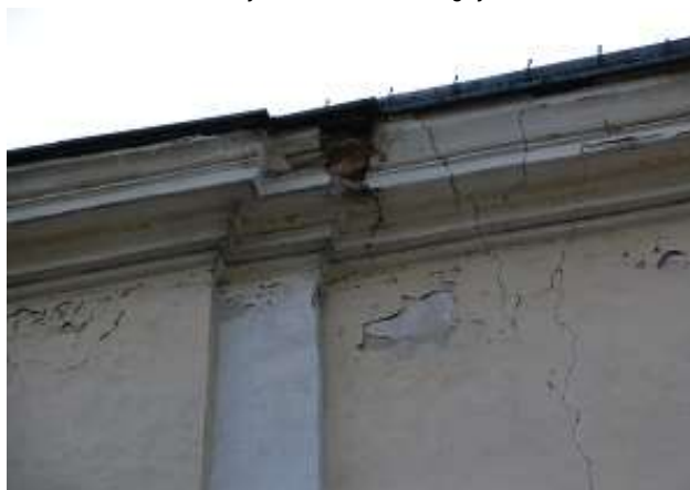
Fot. 35 Przykład uszkodzenia gzymsu.
