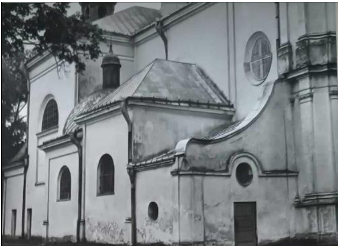
62. Zdjęcia z opracowania L. Szindler "Rozpoznanie stanu technicznego zespołu kościoła parafialnego w Karczewie, pow. otwocki". Zbiory Archiwum Wojewódzkiego Urzędu Ochrony Zabytków w Warszawie, sygn. 310 A-C.
