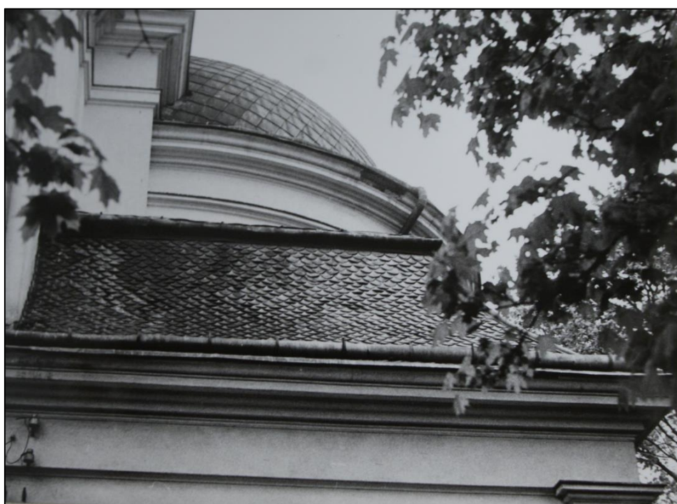
64. Zdjęcia z opracowania L. Szindler "Rozpoznanie stanu technicznego zespołu kościoła parafialnego w Karczewie, pow. otwocki". Zbiory Archiwum Wojewódzkiego Urzędu Ochrony Zabytków w Warszawie, sygn. 310 A-C.
