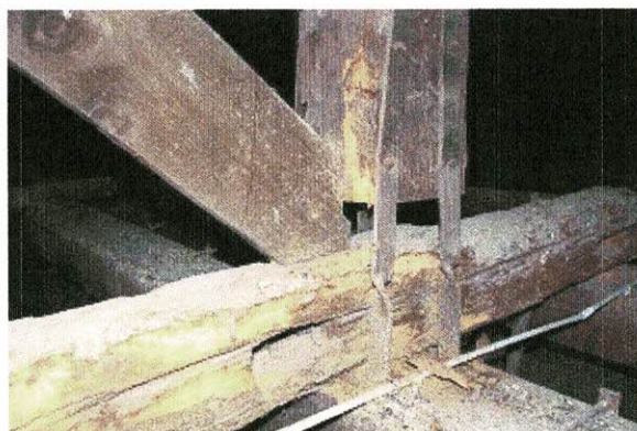
Fot. 4 Przykład korozji drewna.
