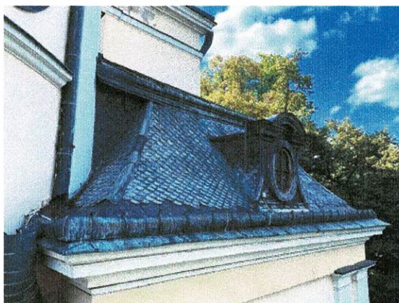
Fot. 9 Widok dachu ze śladami zużycia pokrycia i obróbek.
